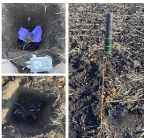
Рисунок 43. Установка систем автоматизированного мониторинга за влажностью почвы и уровня грунтовых вод
