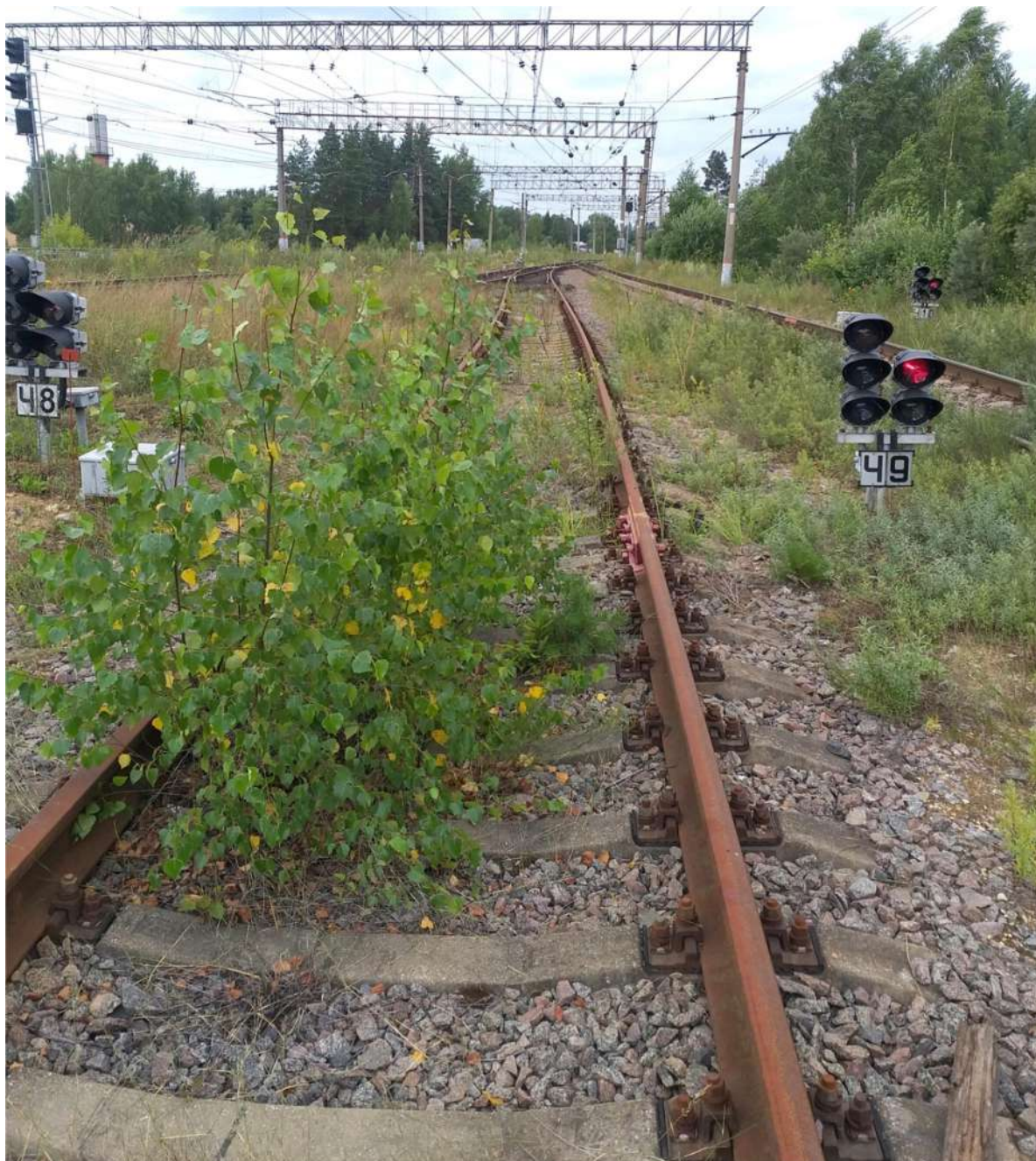
Рис. 14. На части станций БМО путевое развитие с 1990-х годов законсервировано и зарастает древесными растениями (ст. Поварово-3).
