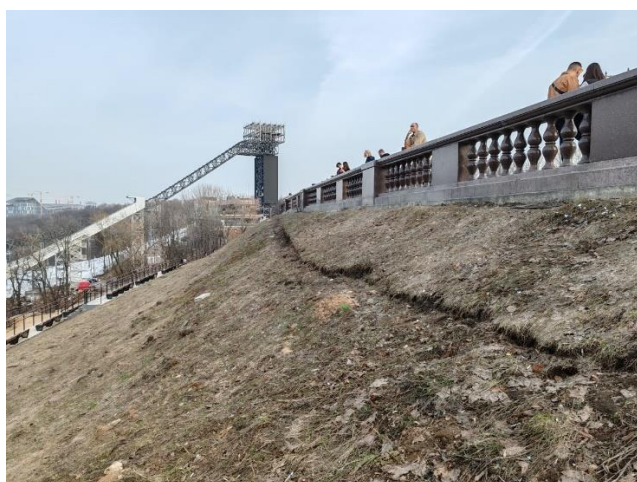
Рис. 3.2.1. Трещина отседания у смотровой площадки как признак оползневой активности склона. Фото автора от 04 апреля 2024 г.
