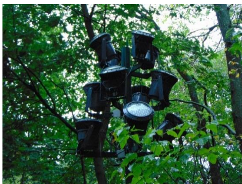
Рис. 4.2.1. Проекторы ландшафтного освещения на опоре
