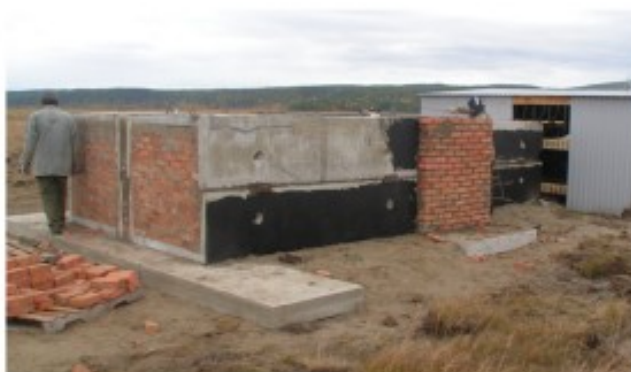
Рисунок 2.5 — Конструкция подземной части станции №14 и ее вид на этапе строительно-монтажных работ. Размеры приведены в мм.
