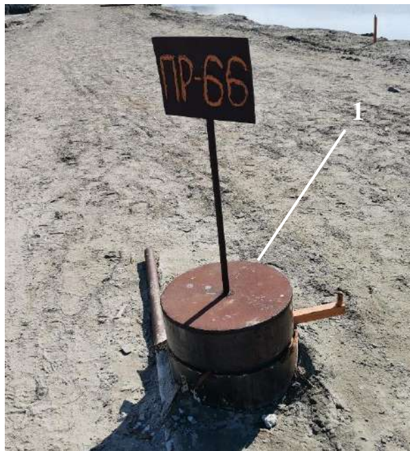
Рис. 132. Консервация подземного резервуара для захоронения отходов бурения 1 – крышка для предотвращения попадания осадков в подземный резервуар
