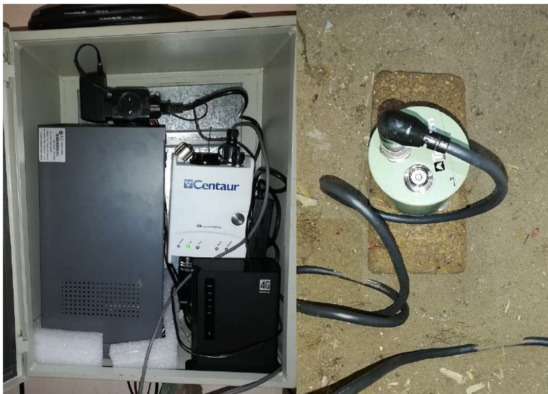
Рисунок 4.3. Оборудование станций UGL2 и UGL3. Слева — регистратор сейсмических сигналов и оборудование бесперебойного питания и передачи данных в телекоммуникационном ящике, справа — сейсмометр в заглубленной сейсмокамере
