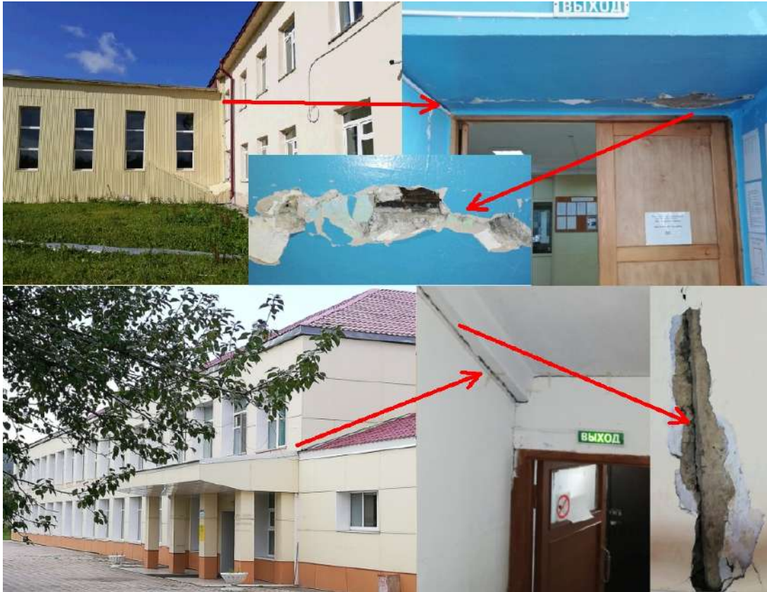
Рисунок 2.5. Выявленные повреждения зданий школ в селах Никольское (вверху) и Краснополье (внизу) по результатам макросейсмического обследования эпицентральной зоны Угледорского землетрясения 13.09.2020 г.
